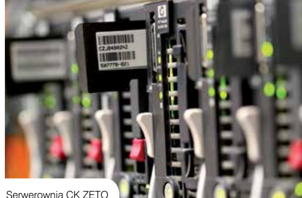
Serwerownia CK ZETO
